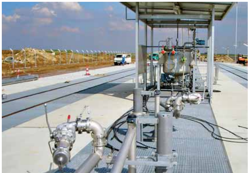
Entladeanlage für Kesselwagen auf Flughäfen.
